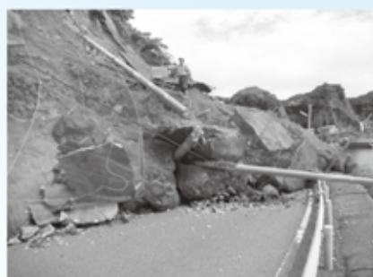
崖崩れによる被害(平成20年6月 新宮)
