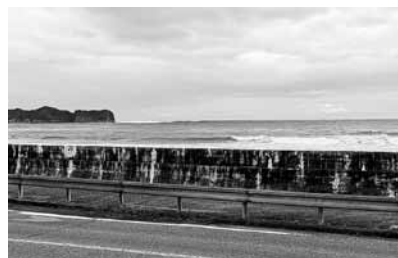
ペイントが剥がれた串浜の海岸堤防
